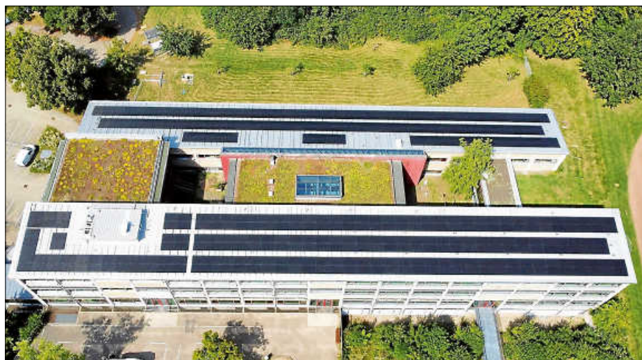
Ein Blick von oben zeigt die Größe der Anlage. Insgesamt 450 Module wurden auf dem Dach der Pestalozzischule verbaut. Bild: BEG
