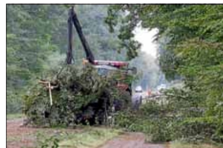
Sturmschäden in Bruchhausen
